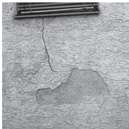
Рис. 8. Трещина на стене и повреждение штукатурки на фасаде здания без применения СФТК, расположенного по соседству с объектом 32 (Eberstrasse, 2).
