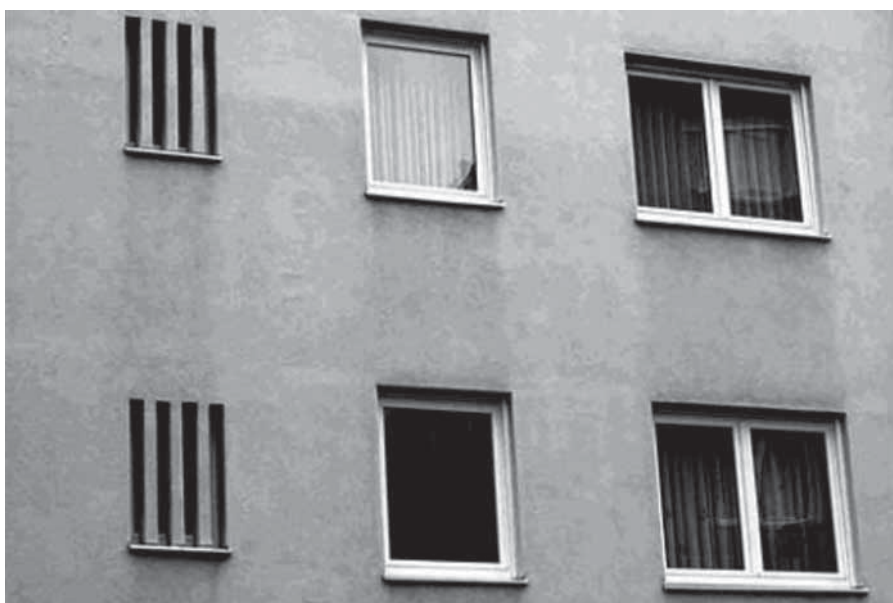
Рис. 5. Фрагмент северного фасада объекта 51 в Нюрнберге через 17 лет после проведения ремонтных работ, заключавшихся в наложении нового слоя покрытия в 1987 г. Участки между окнами, которые подвергались сильному воздействию дождя, более светлые. Это свидетельствует о том, что воздействие дождя на эти участки не привело к образованию водорослей, а носило очищающий характер.
