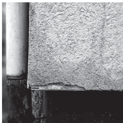
Рис. 9. Пример повреждения нижней части фасада на западной стороне объекта 31, вызванного прониканием влаги в соединительный профиль (возможно, из-за неисправной водосточной трубы).
